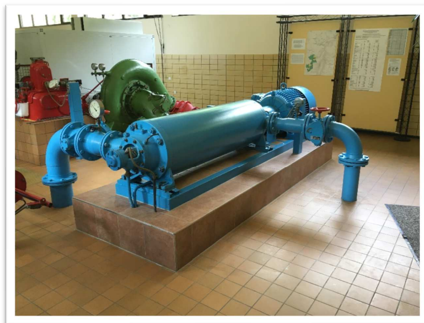
Bild 4: Ansicht auf die bestehende Reinwasserförderpumpe
