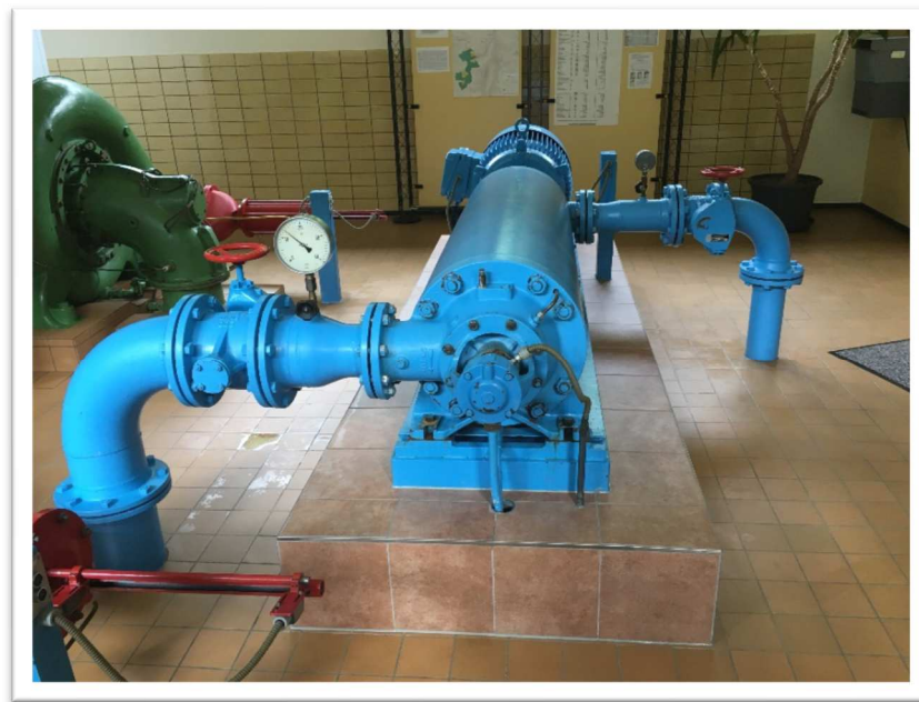
Bild 1: Ansicht auf die bestehende Reinwasserförderpumpe
